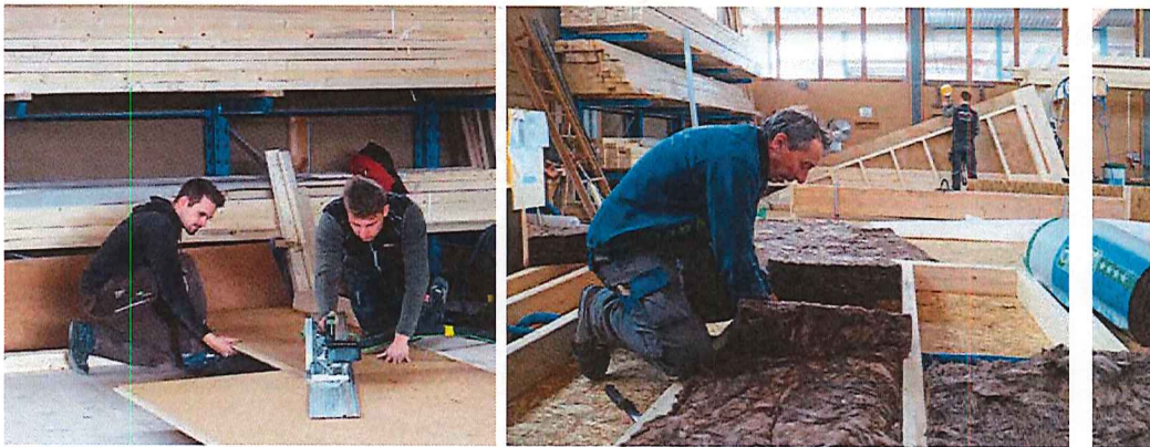
Beim Sägen und Dämmen: Arbeiter der Edi Willi AG – auf dem rechten Bild Wisi Bleisch – im Einsatz.
