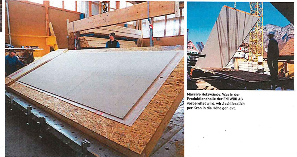
Am Boden, in der Luft und schliesslich auf dem Dach: Hier sind Spezialisten am Werk.
